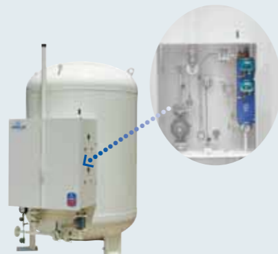
储罐供应系统 BAIO
